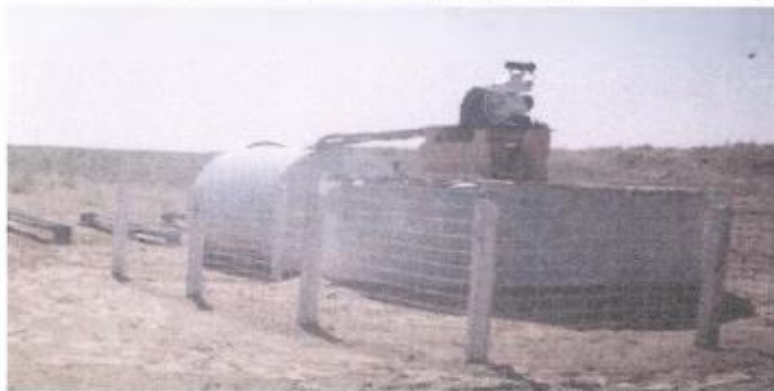
Сооружение водозаборное Обводнение пастбищ с водозабором из шахтного колодца на землях Юстинского СМО Юстинского района Республики Калмыкия. Водопойный пункт №1
