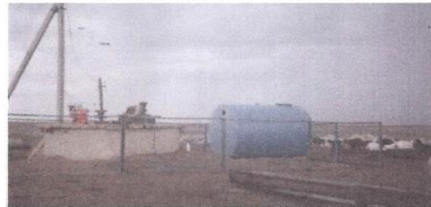
Сооружение водозаборное Обводнение пастбищ с водозабором из шахтного колодца на землях Юстинского СМО Юстинского района Республики Калмыкия. Водопойный пункт №2
